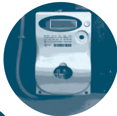
Il contatore dell'energia elettrica
