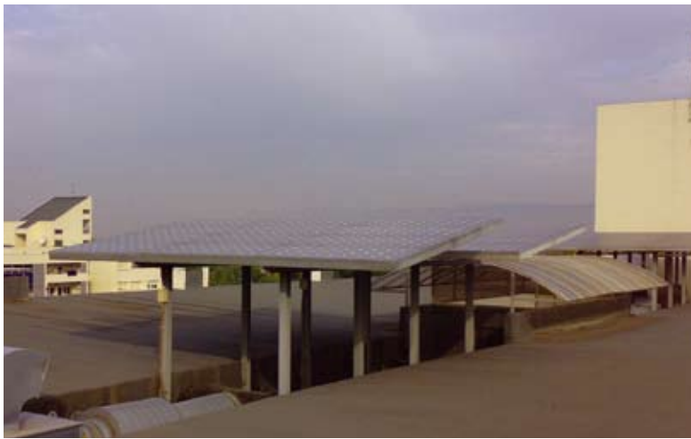
L'impianto fotovoltaico realizzato sulle coperture del fabbricato
