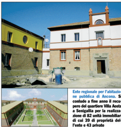
Ente regionale per l'abitazione pubblica di Ancona. Si conclude a fine anno il recupero del quartiere Villa Aosta a Senigallia per la realizzazione di 82 unità immobiliari di cui 39 di proprietà dell'Ente e 43 private
